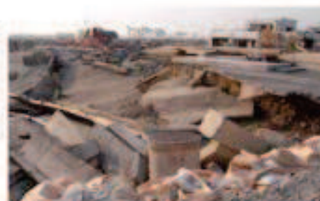
津波でえくれた路盤
