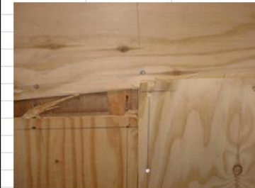
図3 合板真壁破壊状況
