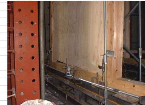
図2 合板真壁破壊状況 受材釘の引き抜
