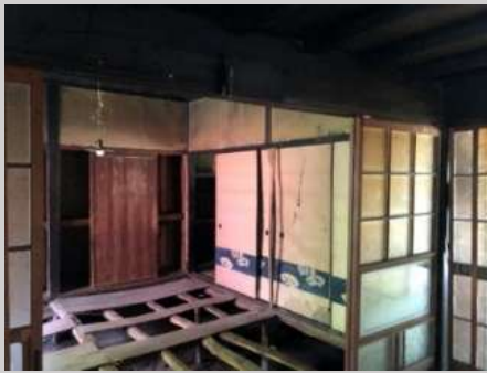
① 5年空き家だった為、床が抜け落ちている
